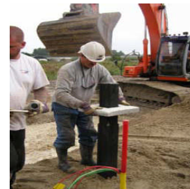
Betonnen tegel over PE-paal
